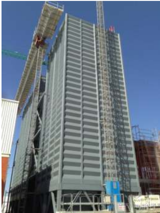
SILOS DE ALMACENAMIENTO
